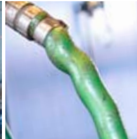
Engates antigos com abraçadeiras de mangueira causam vazamento e queda de pressão
